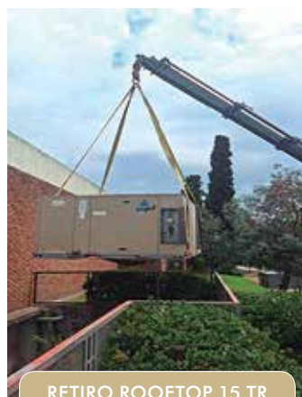
RETIRO ROOFTOP 15 TR (Gimnasio deportivo)
